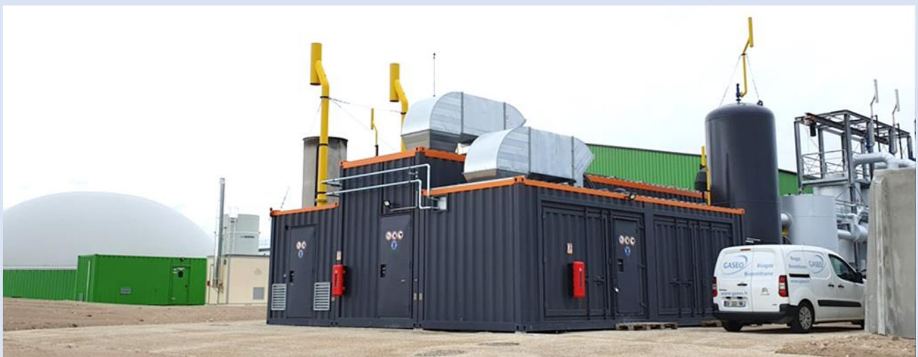
PSA de 520 Nm 3 /h de biométhane - Biogaz d'Arcis (10)
